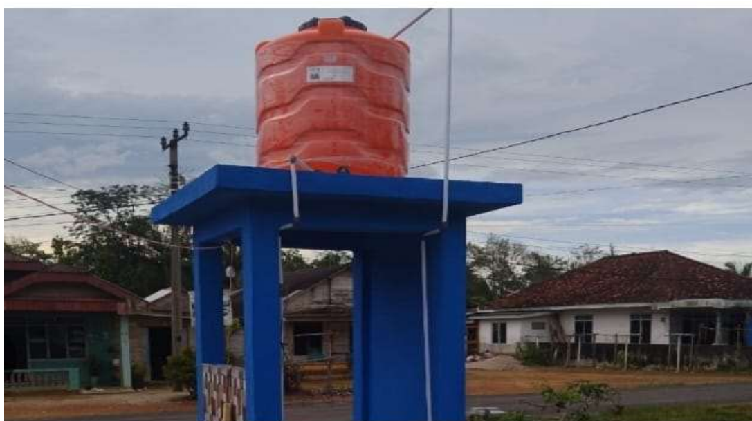
Gambar 3: Sumur Bor Di Desa Motongbang
